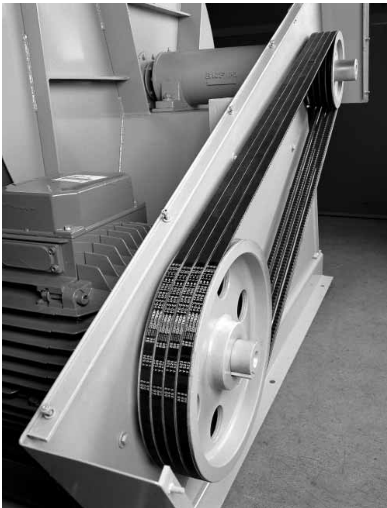
CONTI®-V ADVANCE FO-Z Hochleistungskeilriemen L = L an einem Lüfterantrieb
